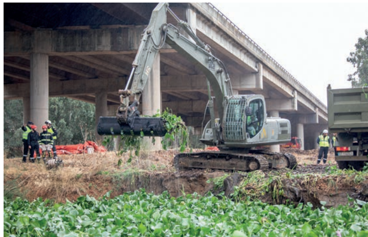
Las retroexcavadoras llevan un cazo a modo de espumadera para poder recoger la mayor cantidad posible de planta.
